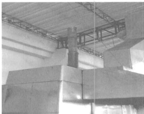
Foto 2. Horno Weston a gas natural con descarga de gases de combustión hacia el exterior de la bodega.
